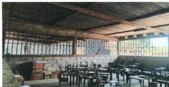
Foto 2: En esta fotografía del módulo 1 se observa el deterioro de la estructura del techo, desprendimiento de laminas.
