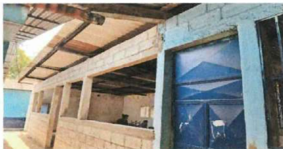
Foto 3: En esta fotografía del módulo 1 se observa el deterioro de la estructura del techo, desprendimiento de laminas y ventanas sin balcones.
