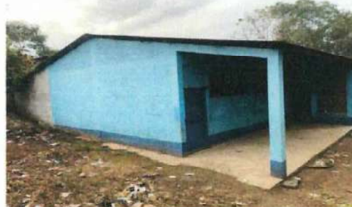
Foto 4: En esta fotografía del módulo 2 se observa el deterioro de la estructura del techo, corredor y desprendimiento de laminas
