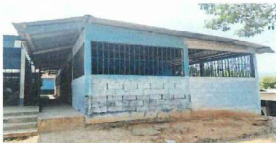
Foto1: En esta fotografía del módulo 1 se observa el deterioro de la estructura del techo, desprendimiento de laminas.
